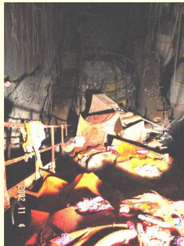
循環ポンプ室
